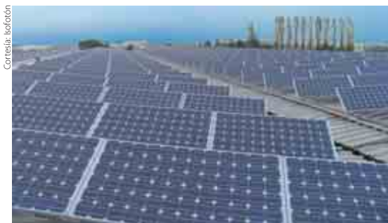
La instalación de un sistema fotovoltaico en el tejado de la fábrica de queso Torelli Pierluigi en Parma (Italia) ha hecho posible reducir los costos.
