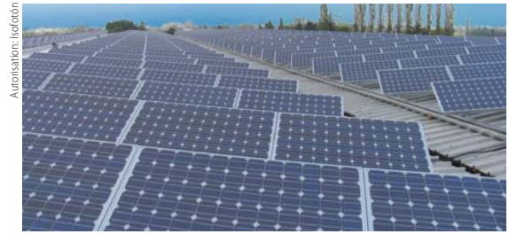
La fromagerie Torelli Pierluigi de Parme (Italie) a réduit ses dépenses grâce aux modules photovoltaïques installés sur le toit de ses usines.
