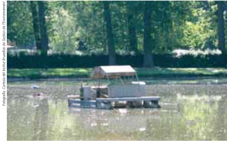
El Aireador Chaipattana instalado en uno de los estanques Mellearts del Parque Woluwe-Saint-Pierre de Bruselas
