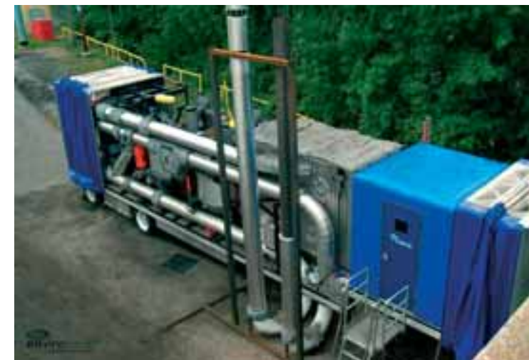
Unidad móvil de EnviroScrub Technologies en las instalaciones de la Potlatch Paper Corporation
