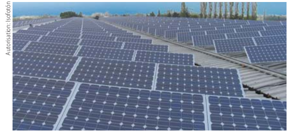
La fromagerie Torelli Pierluigi de Parme (Italie) a réduit ses dépenses grâce aux modules photovoltaïques installés sur le toit de ses usines.
