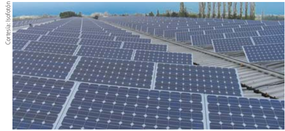
La instalación de un sistema fotovoltaico en el tejado de la fábrica de queso Torelli Pierluigi en Parma (Italia) ha hecho posible reducir los costos.
